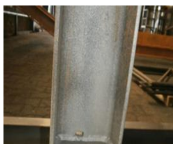
NIEPOPRAWNIE jeden, zbyt mały otwór na środku
