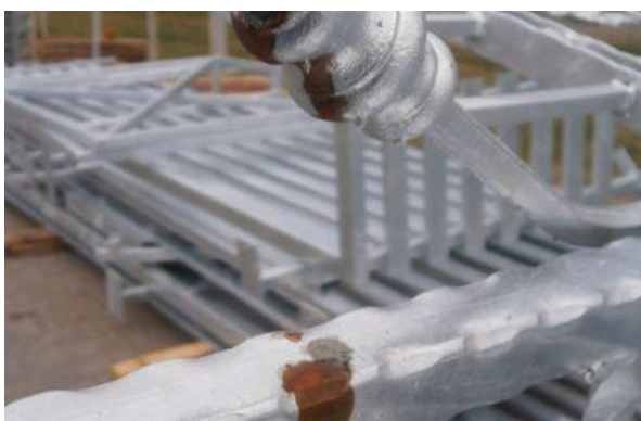
NIEPOPRAWNIE nieszczelna spoina i wyciek mediów z obróbki wstępnej
