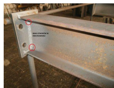
NIEPOPRAWNIE brak otworów
